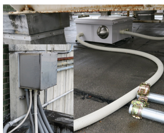
レピータ装置と危機管理課内のパソコン類とは、防水用パイプで保護されたケーブルで結ばれている。
